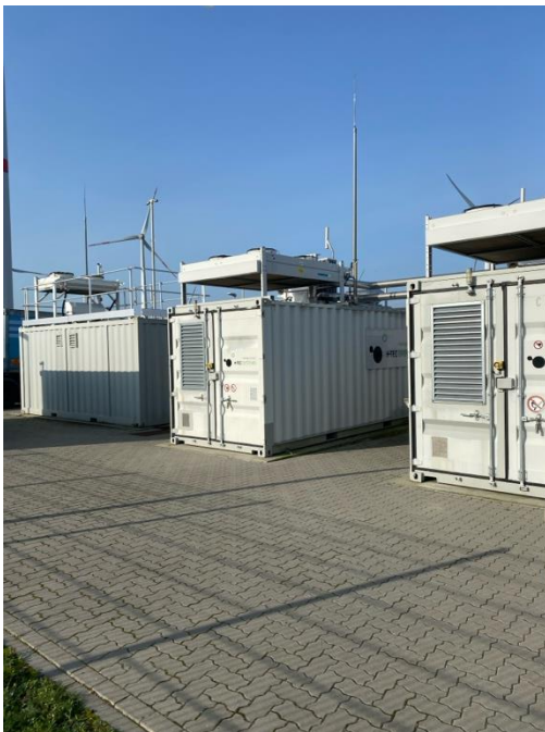
Abbildung 1: Elektrolyseure von außen (eigene Aufnahme 28.09.2023)
