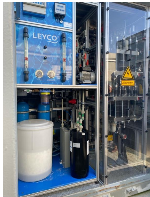
Abbildung 2: Elektrolyseure von innen (eigene Aufnahme 28.09.2023)
